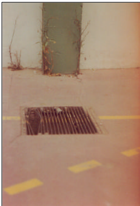
Pista. Rejilla. I.E.S. "Puerto de la Torre". Málaga.
