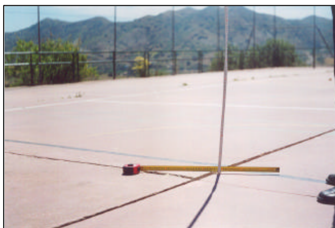
Pista. Grieta. I.E.S. "Valle del Sol". Alora.
