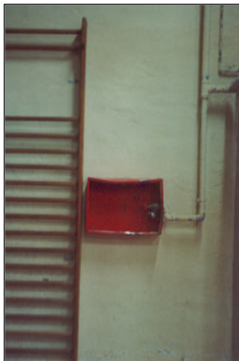
Boca contra incendios.Gimnasio. I.E. S. "Martín de Aldehuela". Málaga.
