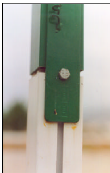
I.E.S. "Guadalmedina". Málaga. Defecto de montaje.
