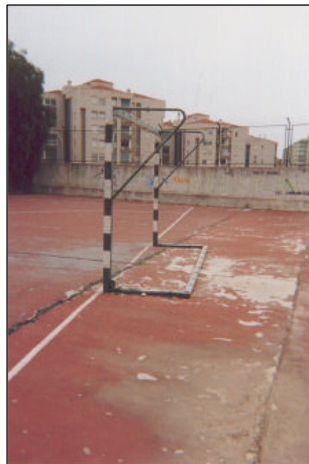
Pista. Grietas. I.E.S. "Pablo Picasso". Málaga.
