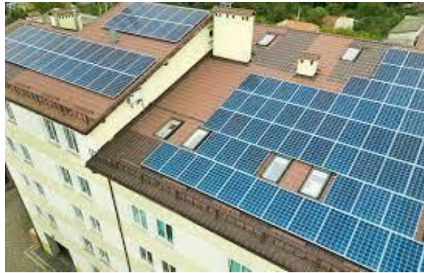
Figura 4. Paneles fotovoltaicos como medida activa.
