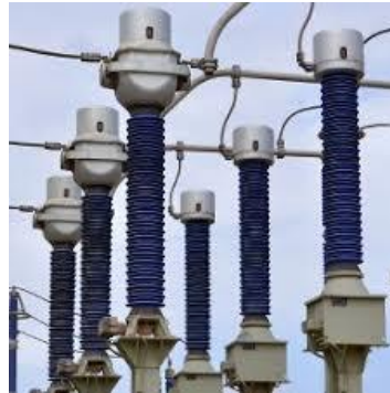
FIGURA 92 TRANSFORMADOR DE TENSIÓN
