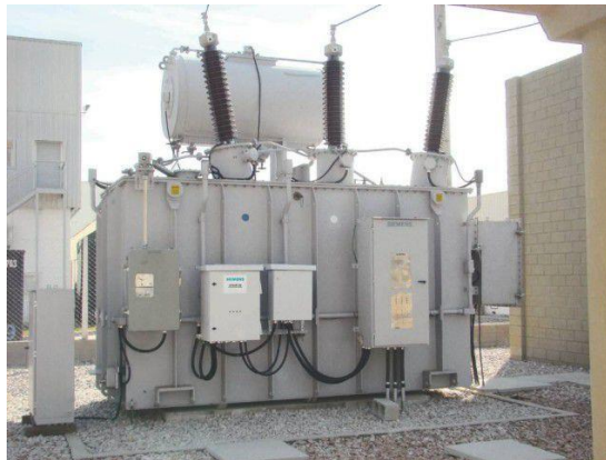
FIGURA 26. TRANSFORMADOR SIEMENS DE 66/20 kV
