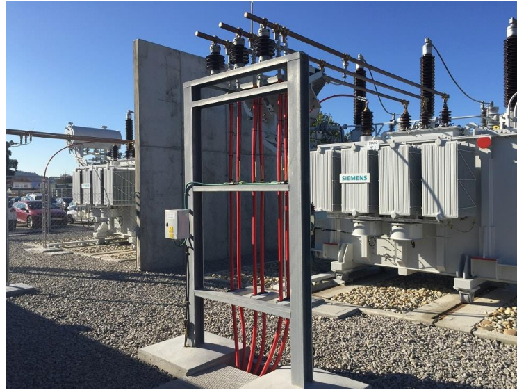
FIGURA 31 EMBARRADO TRANSFORMADOR MT
