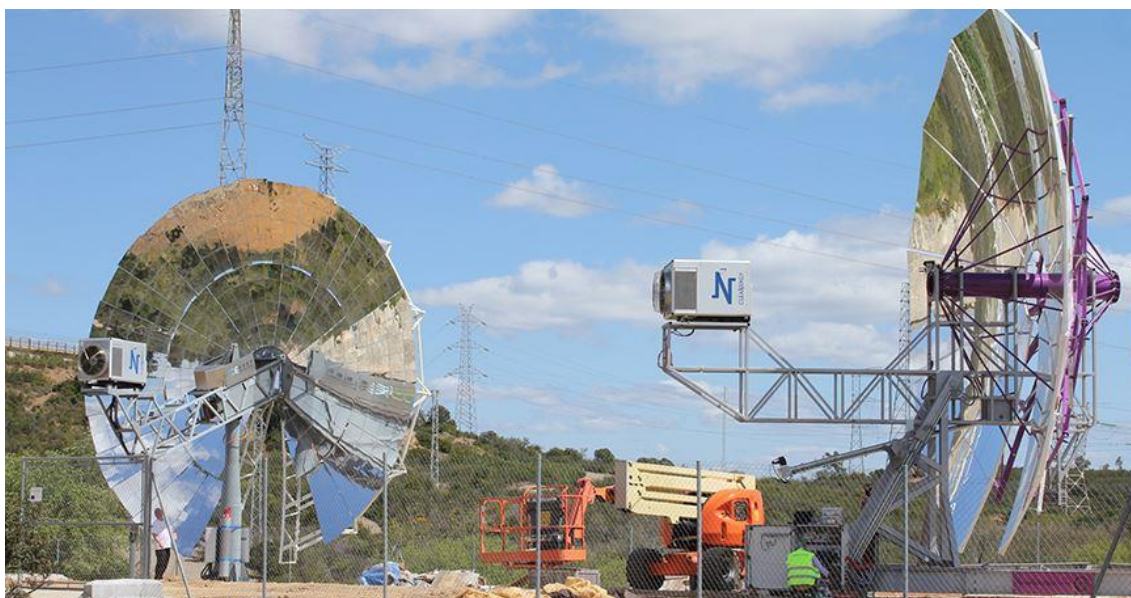
Figura 2.8: Colectores solares con motor Stirling del proyecto SOLARDIS
