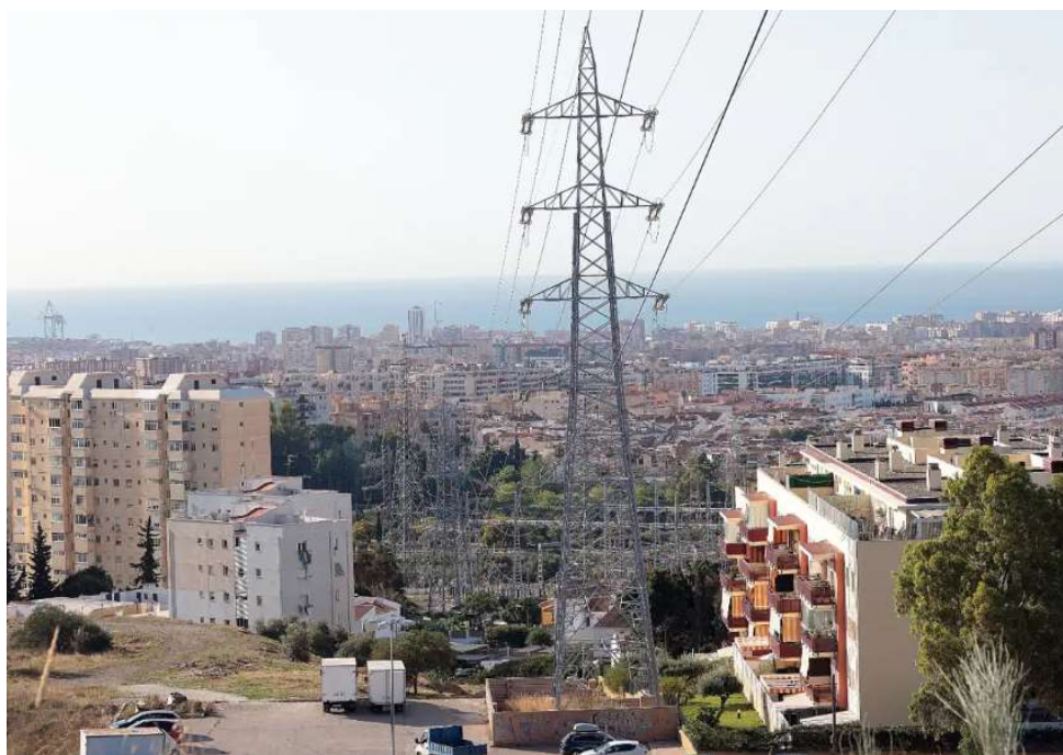
Figura 2. 3. Línea eléctrica de alta tensión en Málaga. Fuente: Jiménez, 2023
