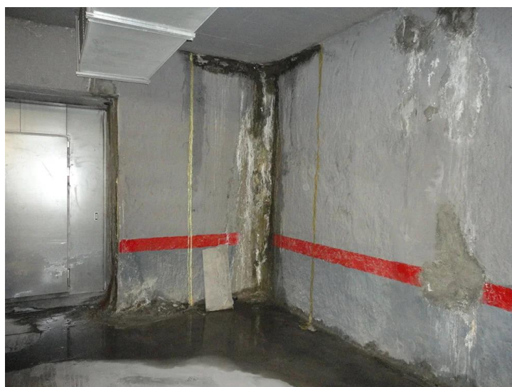
Figura 20: Fotografía de un muro con filtraciones. Fuente: Página oficial de Humicontrol.
