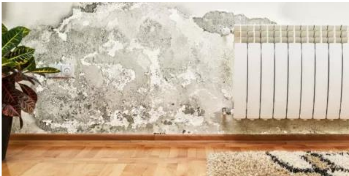
Figura 19: Fotografía de un muro con humedades por capilaridad. Fuente: Página oficial de Sika.
