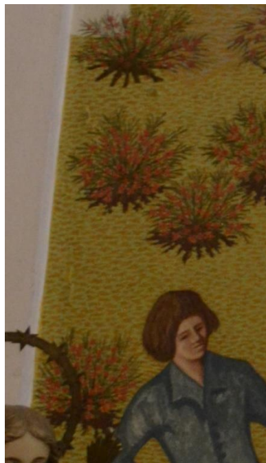
Figura 33: Fotografía de desperfectos en muro 11. Fuente: Realización Propia con cámara Nikon D5200.
