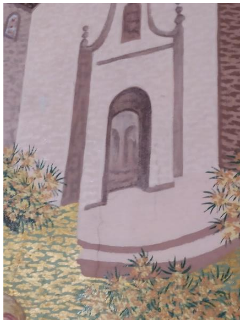
Figura 26: Fotografía de desperfectos en muro 5. Fuente: Realización Propia con cámara Nikon D5200.
