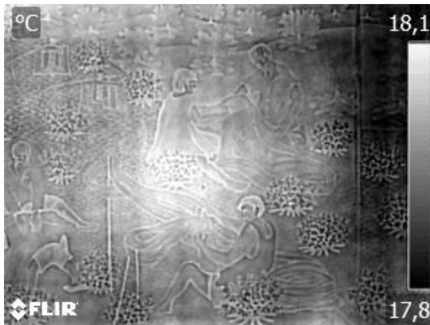
Figura 108: Fotografía infrarroja del muro 3 con la alarma “Humedad”. Fuente: Realización propia con cámara infrarroja FLIR E75 el día 20 de abril de 2025 a las 15:40 horas.
