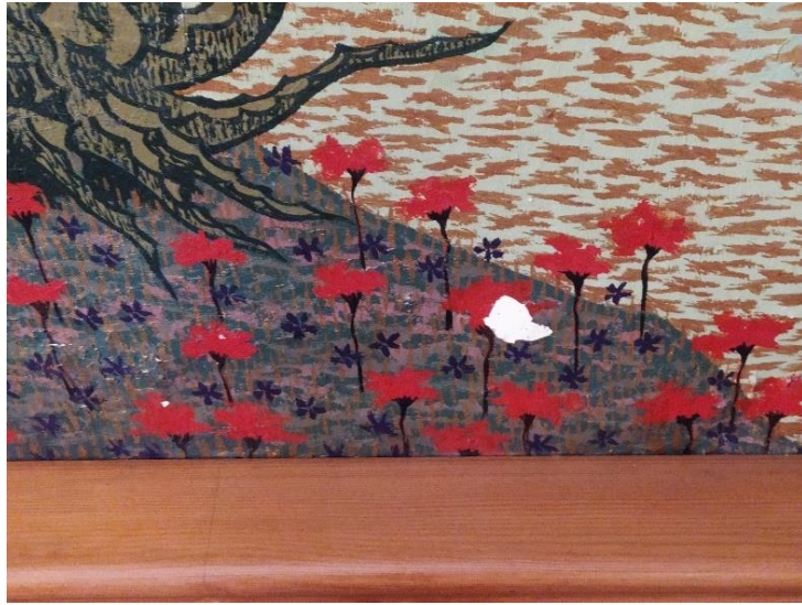
Figura 30: Fotografía de desperfectos en muro 9. Fuente: Realización Propia con cámara Nikon D5200.
