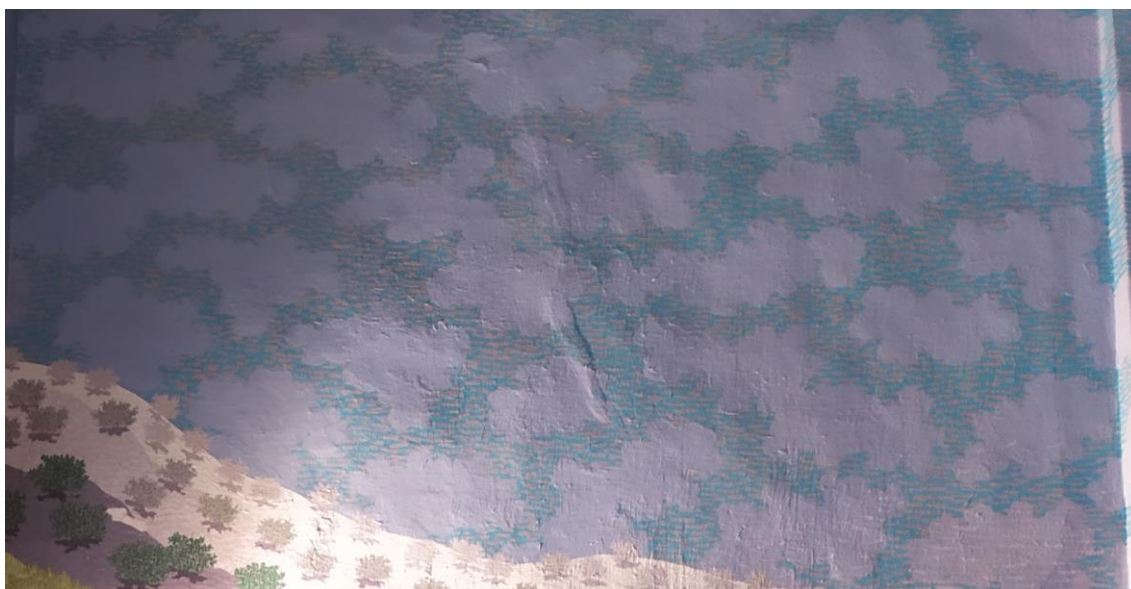
Figura 24: Fotografía de desperfectos en muro 3. Fuente: Realización Propia con cámara Nikon D5200.
