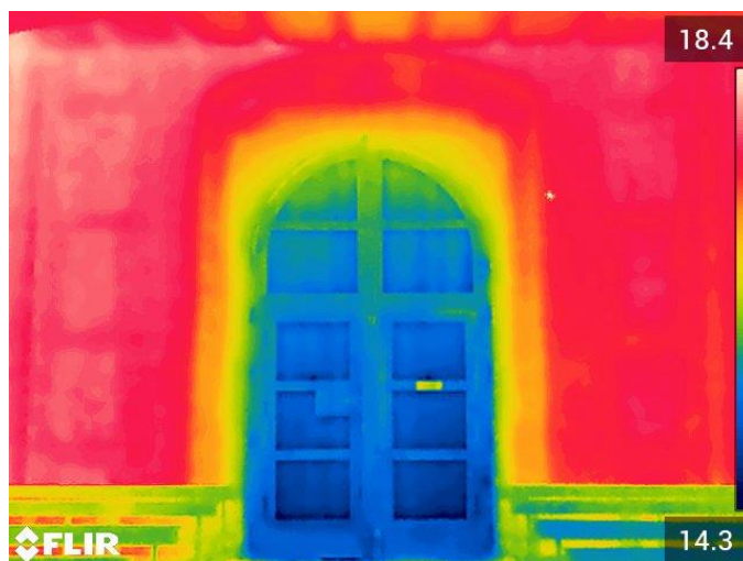
Figura 66: Fotografía de la puerta principal de la ermita. Fuente: Realización propia con cámara infrarroja FLIR E75 el día 16 de abril de 2025 a las 10:00 horas.
