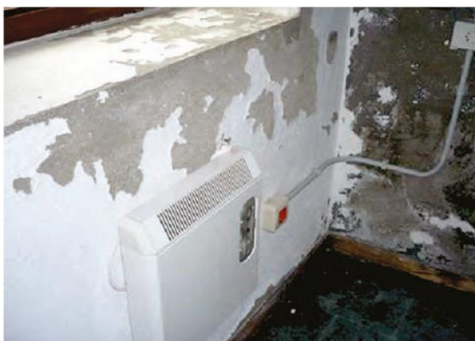
Figura 18: Fotografía de un muro con humedades por condensación. Fuente: Libro "Humedades" de Luis Humberto Casas Figueroa.
