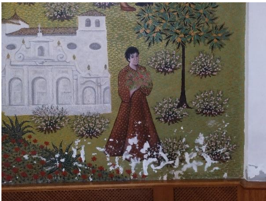
Figura 32: Fotografía de desperfectos en muro 10. Fuente: Realización Propia con cámara Nikon D5200.
