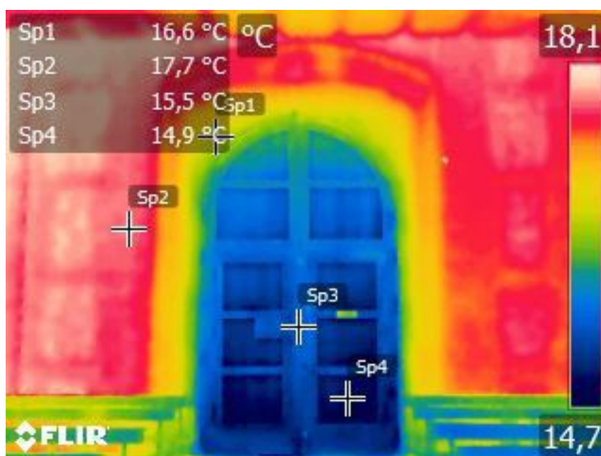
Figura 97: Fotografía de las diferentes temperaturas del puente térmico de la puerta principal de la ermita. Fuente: Realización propia con cámara infrarroja FLIR E75 el día 16 de abril de 2025 a las 10:00 horas.
