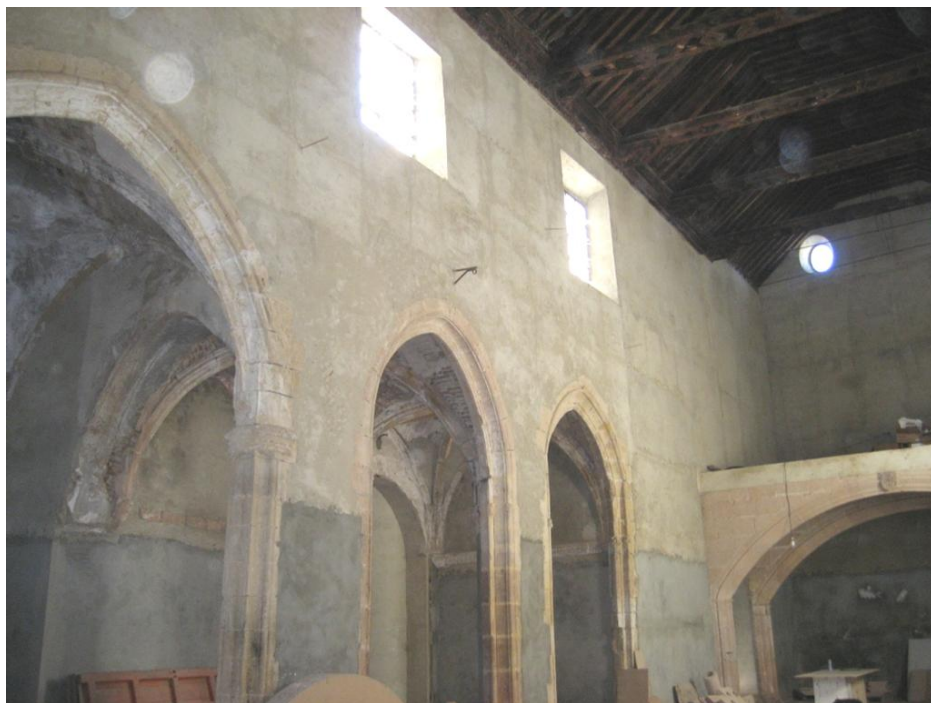
Fig. 8. Capillas en la nave de la epístola de la iglesia de Santo Domingo
