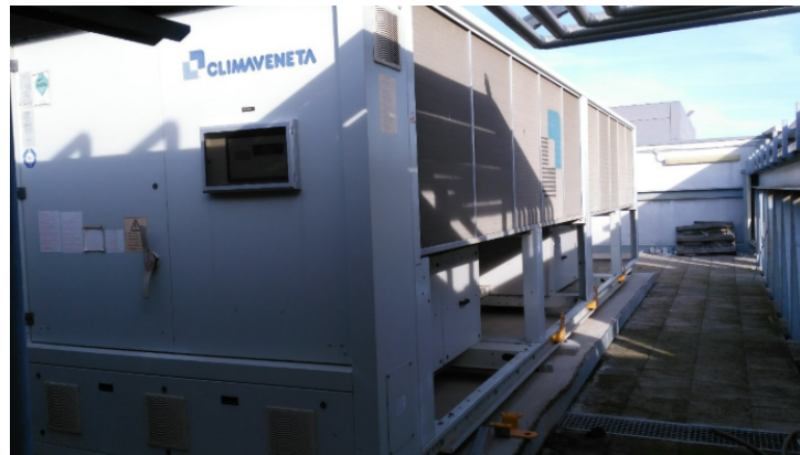
Figura 19: Enfriadora Climaveneta 1000 kW. Fuente: [37]
