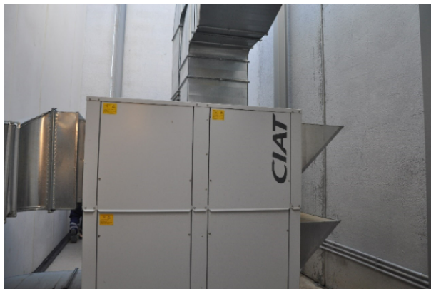
Figura 23: Equipo Rooftop marca CIAT. Fuente: [36]
