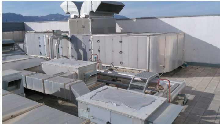
Figura 20: Climatizadores exteriores. Fuente: [37]
