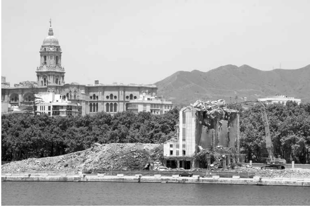
Fig. 4: Demolición del Silo de cereales del puerto de Málaga y Catedral de la Encarnación , junio de 2006. Fotografía: Santana Guzmán A. J.
