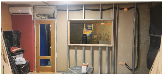
(a) Detalle de la construcción de partición interior entre Control y Sala.
