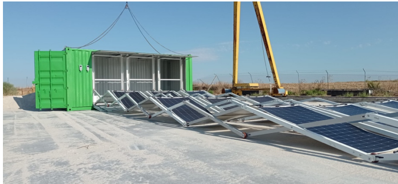
Figura 8. Estación fotovoltaica portátil.
