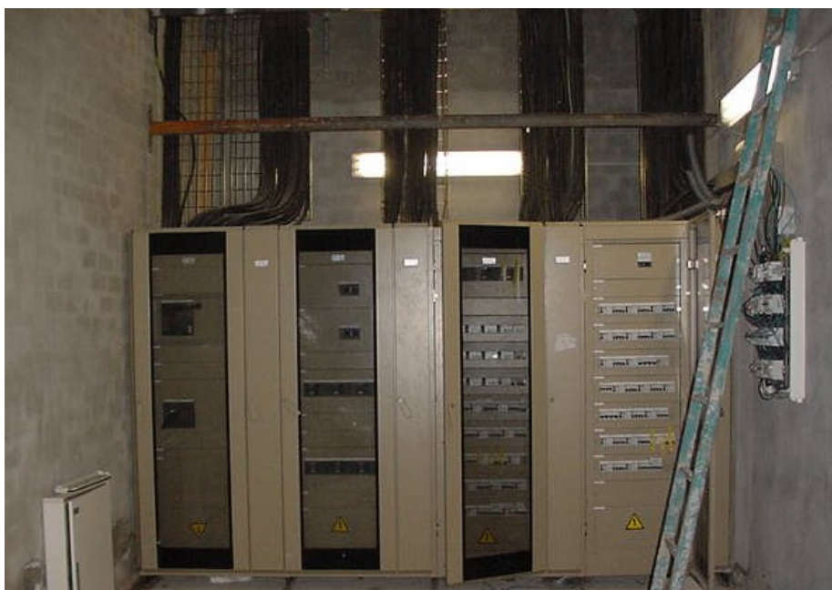
Ilustración 13. Cuadro eléctrico central.
