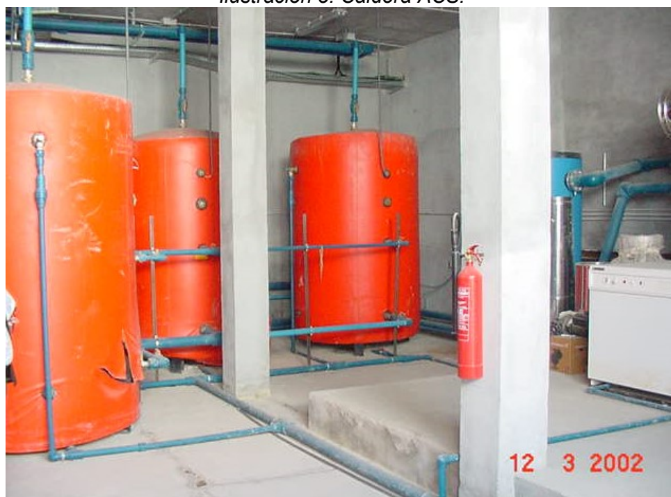
Ilustración 6. Depósitos Acumuladores ACS.
