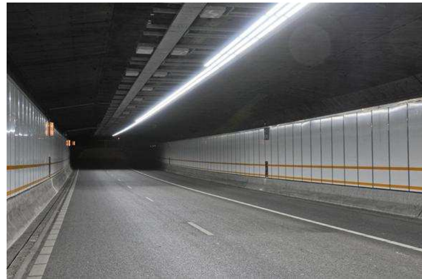
Figura 19. Instalación gradual de luminarias para un ahorro energético y mejor visibilidad.
