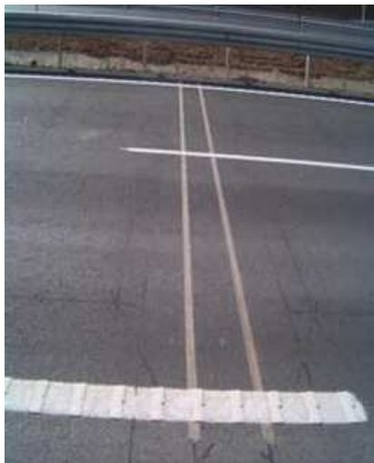
Figura 22. Sensores de presencia en calzada
