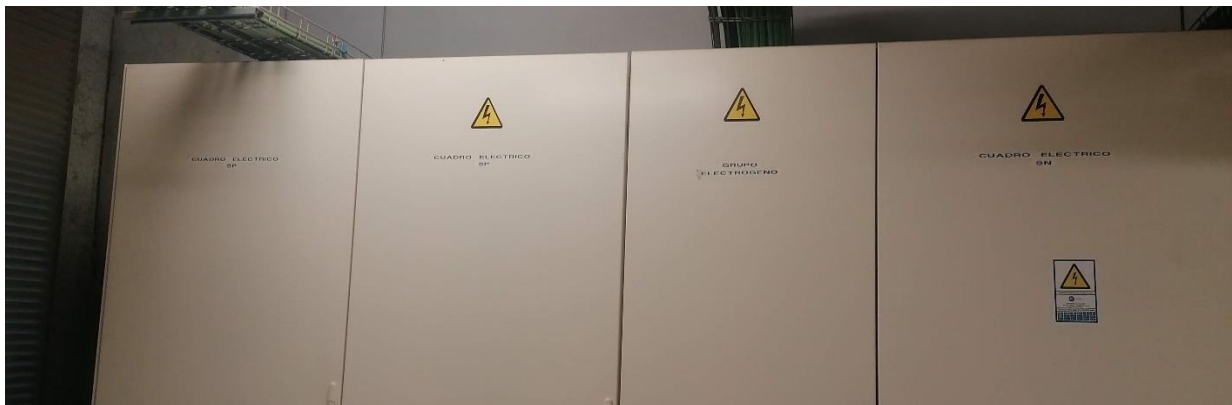
Figura 25. Cuadros eléctricos en la sala de instalaciones
