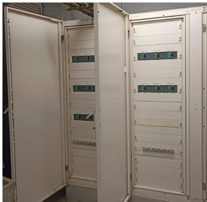
Figura 26. Cuadro General de Baja Tensión
