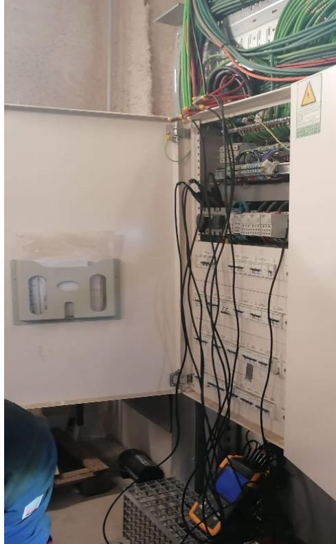
Figura 34. Instalación de analizador de redes en el cuadro CS-EDF A3-S2-SP
