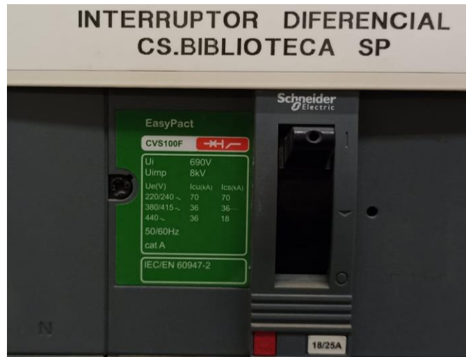
Figura 29. Interruptor diferencial CS. BIBLIOTECA SP
