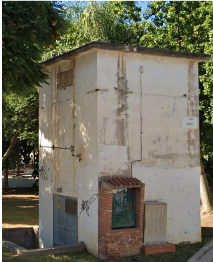
Figura 8. Centro de transformación N.º 195 “TOMILLAR_3”. Fuente: Elaboración propia.
