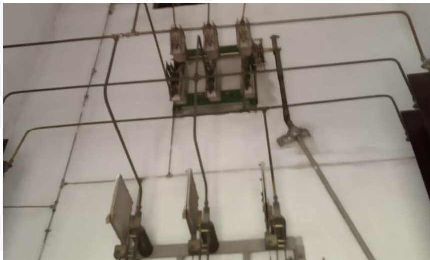
Figura 10. Ejemplo puentes de Media Tensión estado actual.
