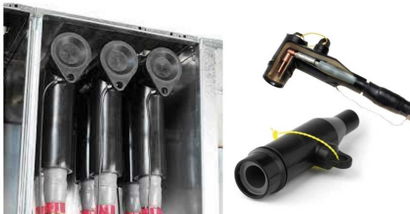
Figura 15. Terminaciones enchufables en celdas de Media Tensión. Fuente: Catálogo de Ray Tech.
