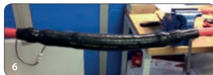
6 La junta está lista y puede ponerse inmediatamente en funcionamiento
