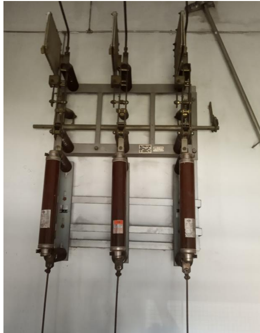
Figura 12. Ejemplo de fusibles de protección de transformador existente.
