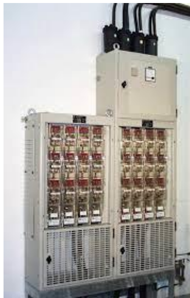
Figura 13. Cuadro de Baja Tensión existente.
