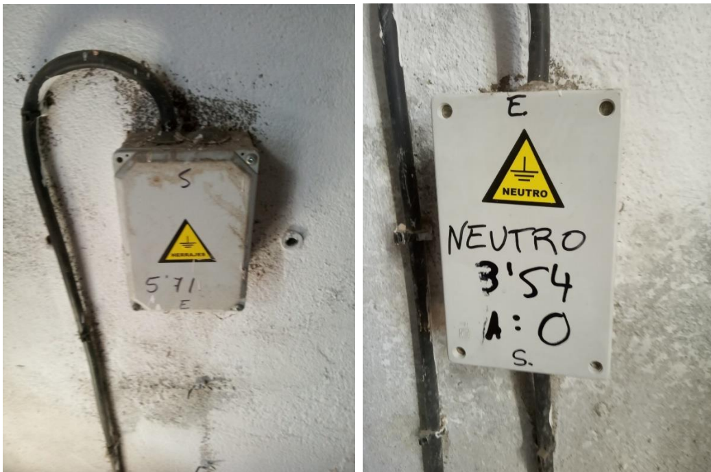
Figura 20. Resistencia de neutro y herrajes del centro de transformación.
