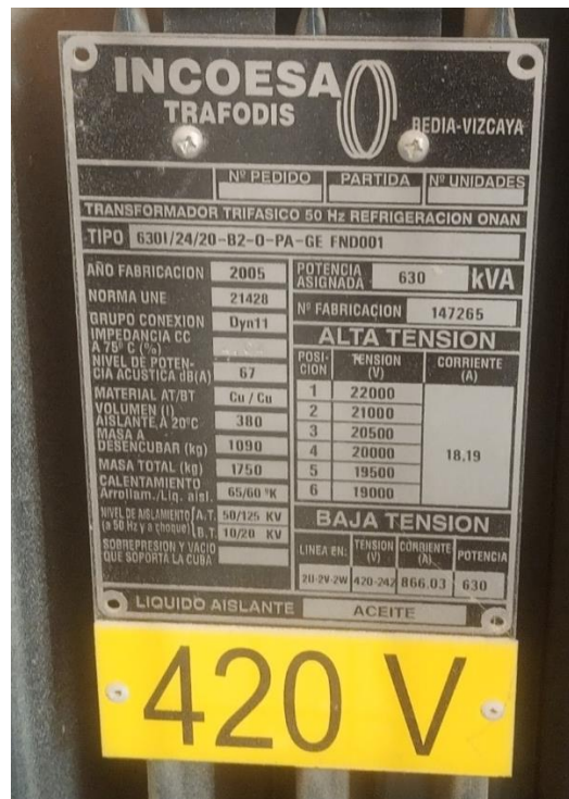
Figura 9. Placa característica del transformador.
