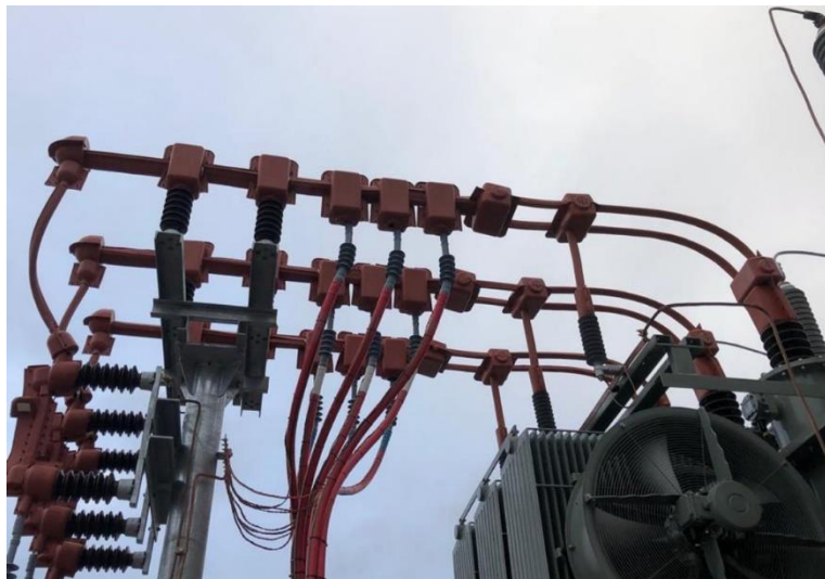
Figura 44. Ejemplo de una subestación forrada con soluciones termoplásticas (Fuente: EnverTec, 2020)
