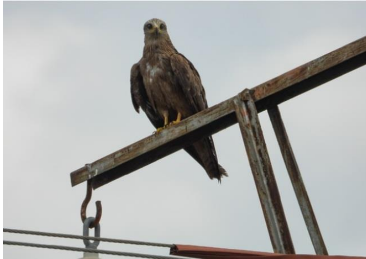
Figura 1. Imagen de un Milano Negro sobre apoyo de línea eléctrica aérea (Fuente: Torrescusa, 2024)
