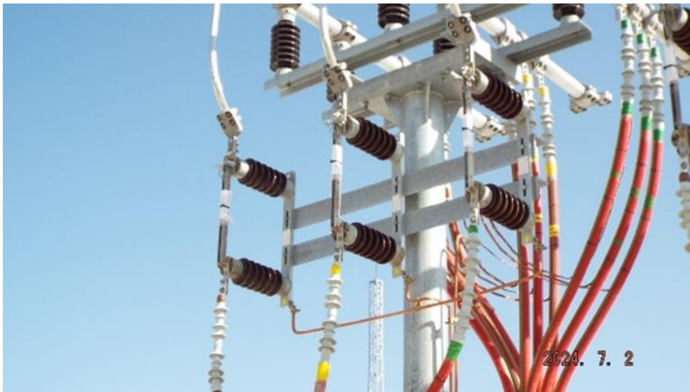
Figura 38. Grapa en situación de funcionamiento (vista del seccionador)
