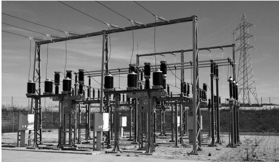
Figura 19. Ejemplo de Subestación (Cuerva, 2024)
