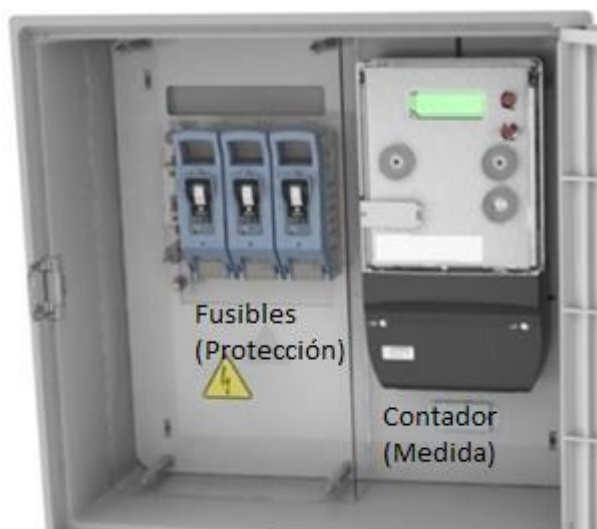
Ilustración 8: Caja de protección y medida.
