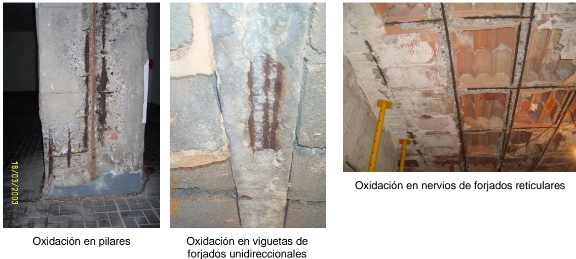
Figura 21. Oxidación de armaduras en distintos elementos estructurales por escasez de recubrimiento de las armaduras Para dotar de recubrimiento a las armaduras se utilizan los separadores o calzos.
