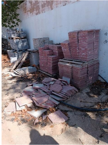
Ilustración 62. Zona de solerías. Riesgo de caídas.
