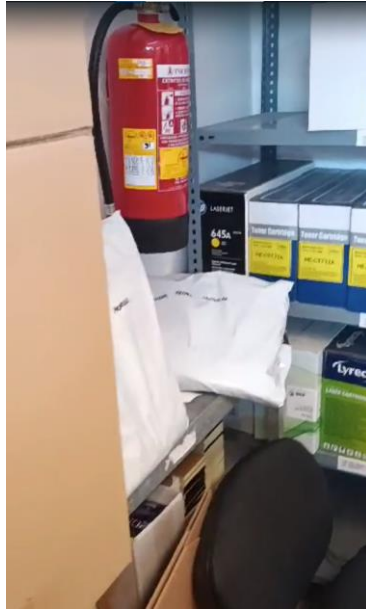
Ilustración 37. Extintor en una zona de no fácil acceso.
