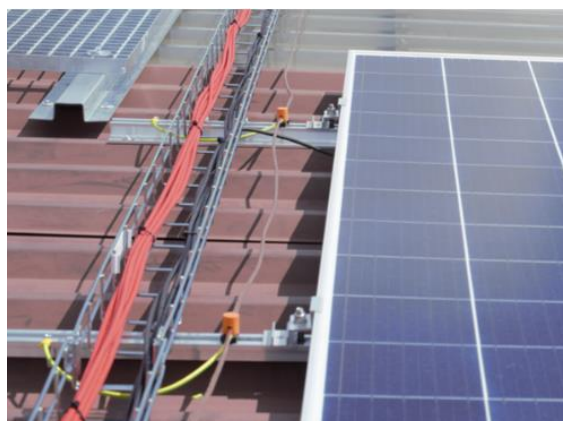
Ilustración 49. Conexión de puesta a tierra.
