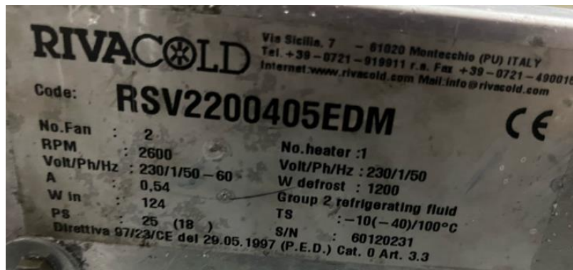
Ilustración 8. Placa de características cámara frigorífica.
