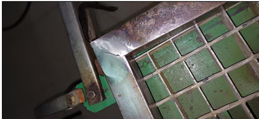
Figura 33. (a) Estructura con base inferior soldada, (b) Proceso de desbastado de soldadura.
