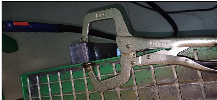
Figura 36. (a) Soldadura de pletina desde una vista general, (b) Soldadura en detalle.
