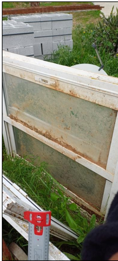
Figura 6. Estado inicial de los soportes para los paneles fotovoltaicos.
