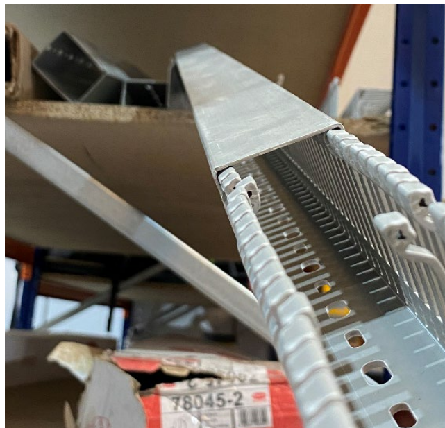
Figura 13: Bandeja perforada en la que se sitúan el cableado de continua, libre de halógeno (Fuente: Elaboración propia)
