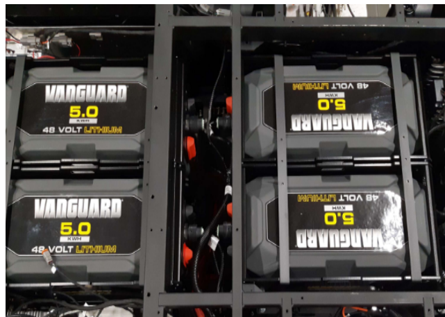
Figura 2.11: Baterías. Fuente: Atlas J8 Operator's Manual (2017).
