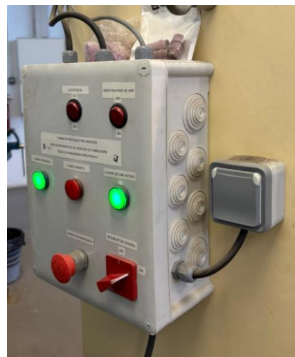
Figura 31. Caja de control eléctrico.
