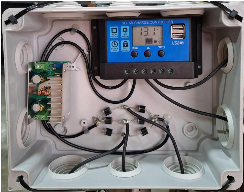
Figura 31. Caja estanca donde se aloja el puente rectificador, el regulador de tensión DC-DC y el controlador de carga. Fuente: Elaboración Propia
