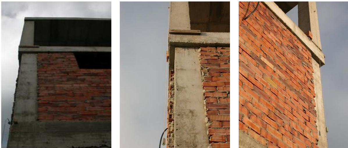
Figura 4-01. Error en el replanteo de pilares que provoca una excentricidad accidental en el eje de los pilares
