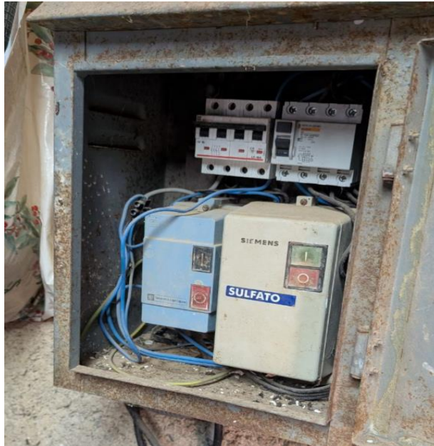
Ilustración 60. Riesgo eléctrico (Fuente Autoría Propia 2025).
