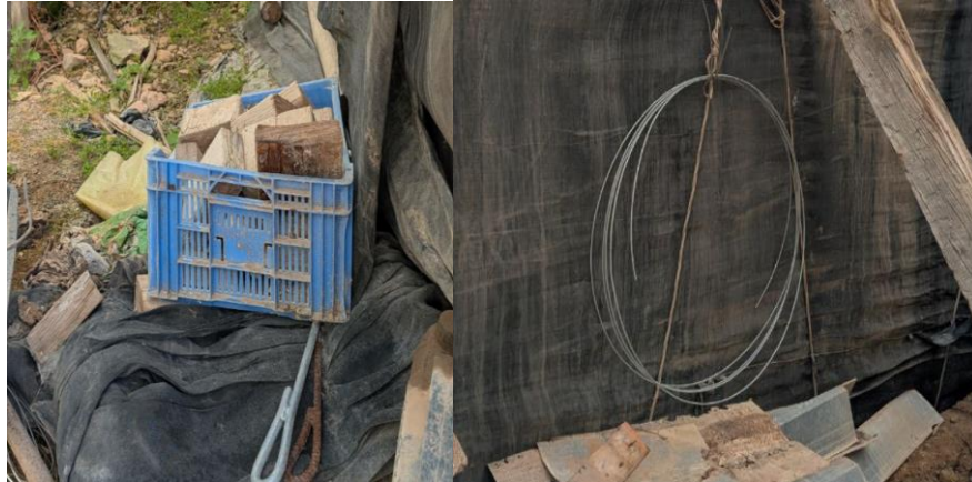
Ilustración 54. Golpes y atrapamientos por la infraestructura
