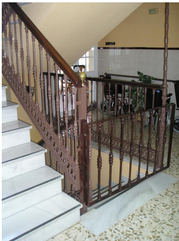
Dispositivos de seguridad en escaleras.
