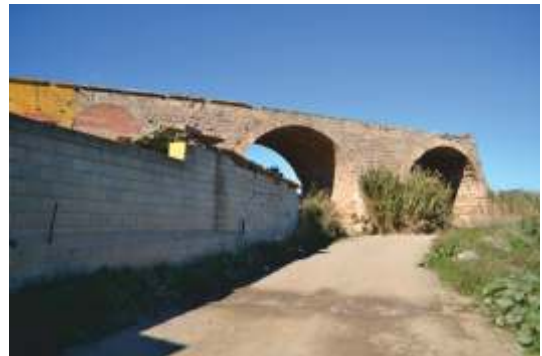
Fig. 9 – Detalle del estado de conservación del inicio del Puente del Rey en el río Guadalhorce y edificaciones anexas, Acueducto de la Fuente del Rey (foto Celia López-Bravo, 2021)
