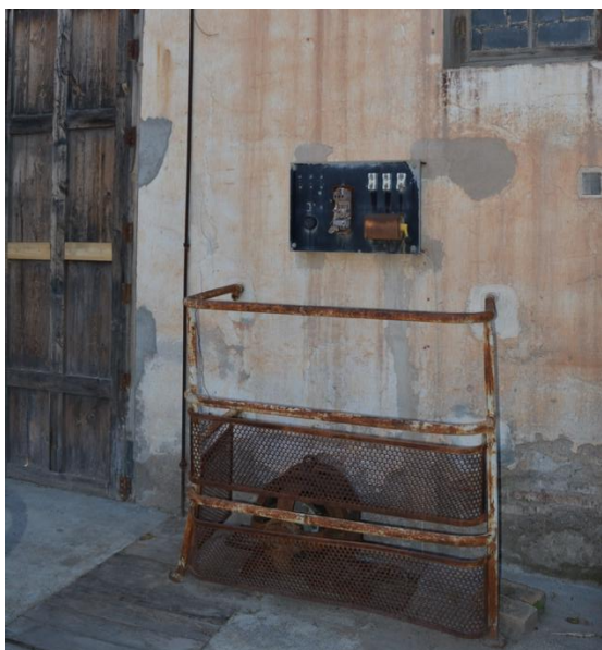
Figura 37. Vista completa motor eléctrico
