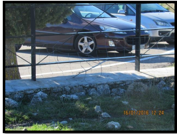
Vallas de protección y seguridad rotas. Fuente: Elaboración propia.
