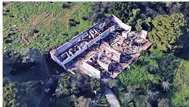
Figura 5: [Casa Alhaurín [de la Torre]]. Estado actual. Google Maps. Situación tras el incendio sufrido en mayo de 2010. Se conservan los muros realizados con granito.
