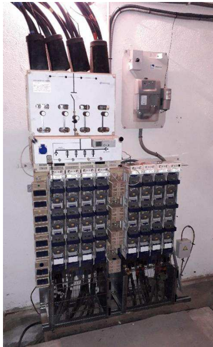
Figura 2.4. Cuadro de baja tensión inteligente [125]
