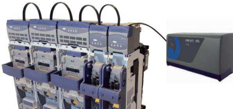
Figura 2.9. Detalle de un cuadro de BT inteligente, con captadores de medidas cableados con una unidad remota de concentración de datos [140]
