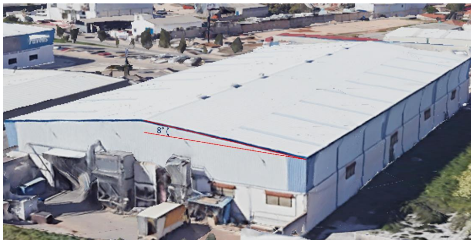
Figura 7. Inclinación de la cubierta.
