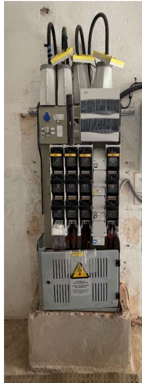
Figura 8. Cuadro de Baja Tensión.
