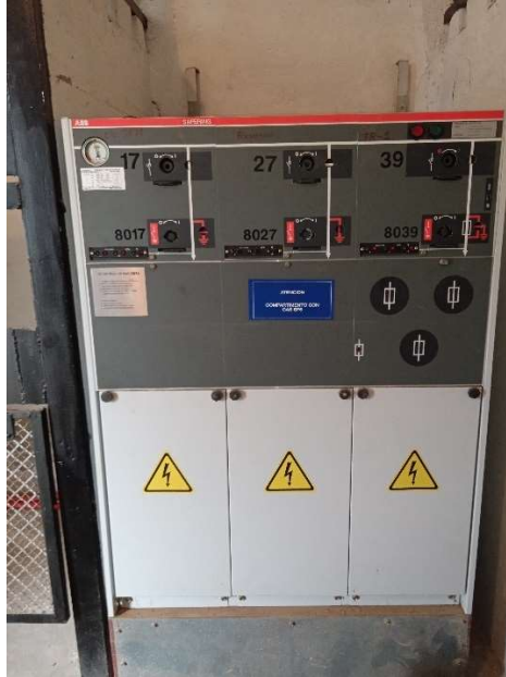
Figura 7. Celdas MT actuales que sustituir.
