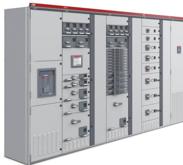
Figura 79. Imagen del cuadro de distribución elegido
