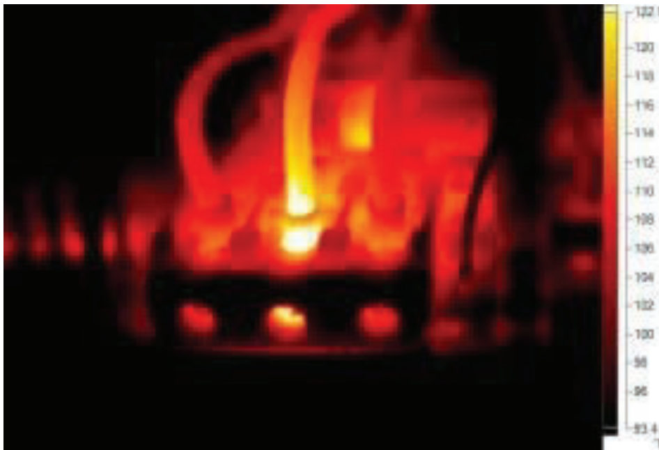
Ilustración 63. Imágen termográfica. Fuente: Imágen cedida por Elecnor.
