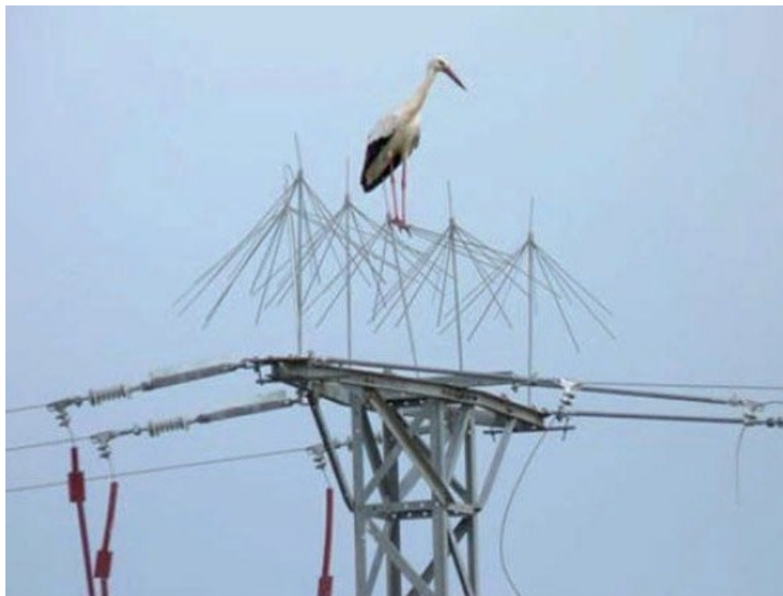
Figura 48. Dispositivos ÁGUILA instalados incorrectamente (Garrido, 2015)
