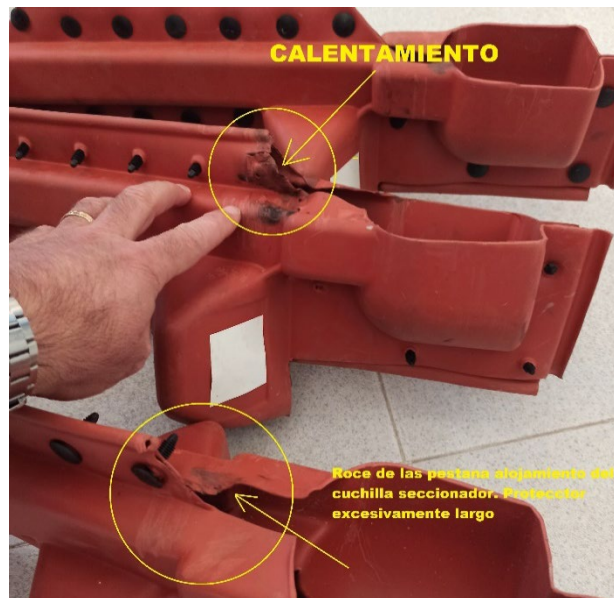
Figura 37. Cubierta para seccionador dañada por el roce contra la cuchilla seccionadora
