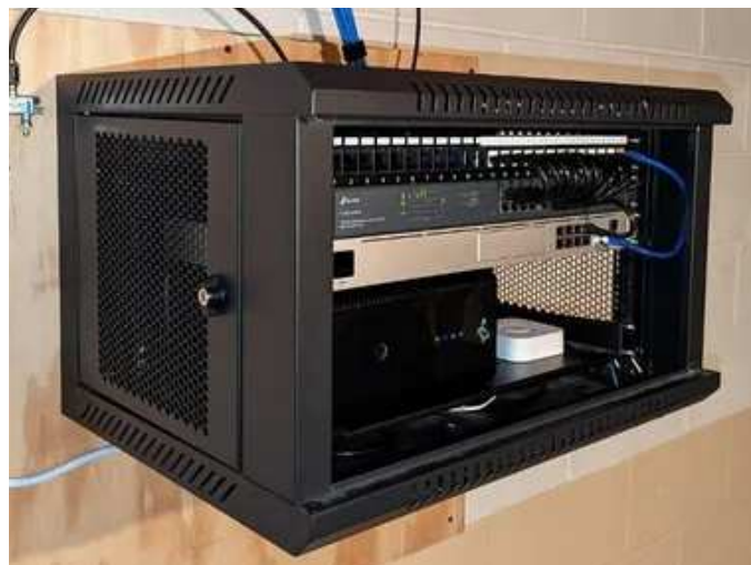
Figura 12. Rack de comunicaciones.
