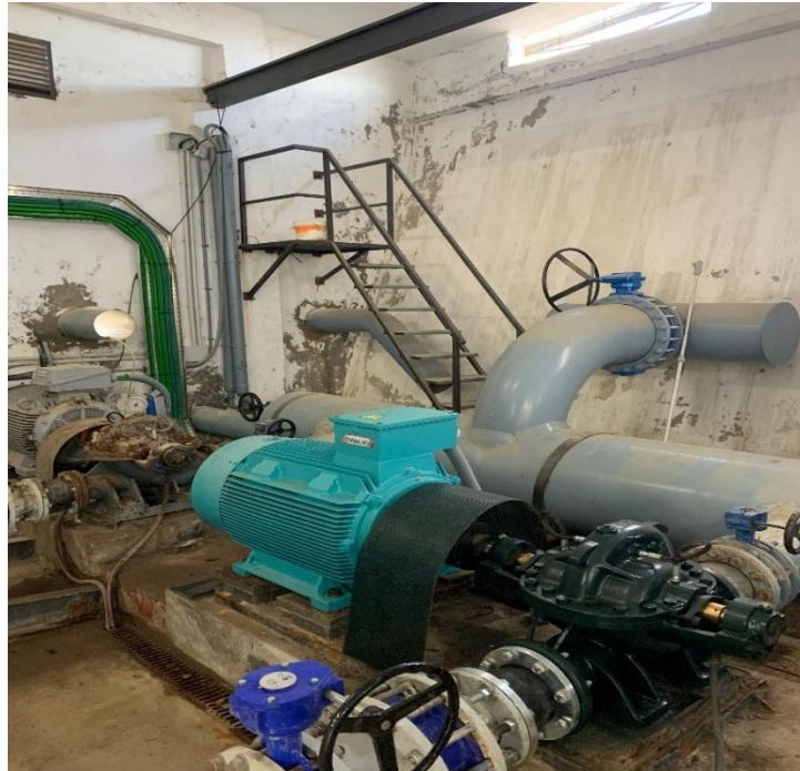
Figura 13. Bombeo de interconexión entre el Depósito 1 y el Depósito 3
