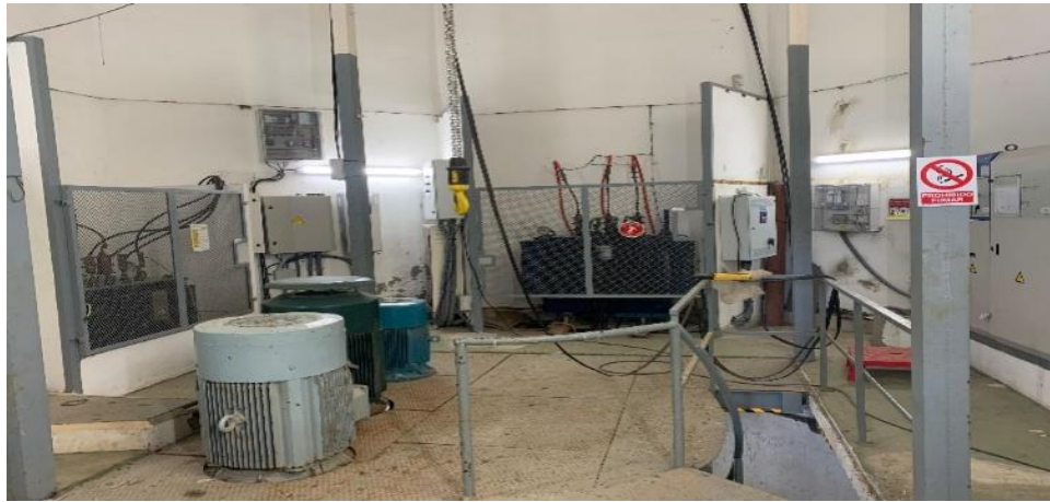
Figura 8. Instalaciones del Pozo Ranney
