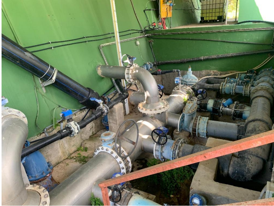
Figura 16. Salida del Depósito 3 a la red de distribución en baja
