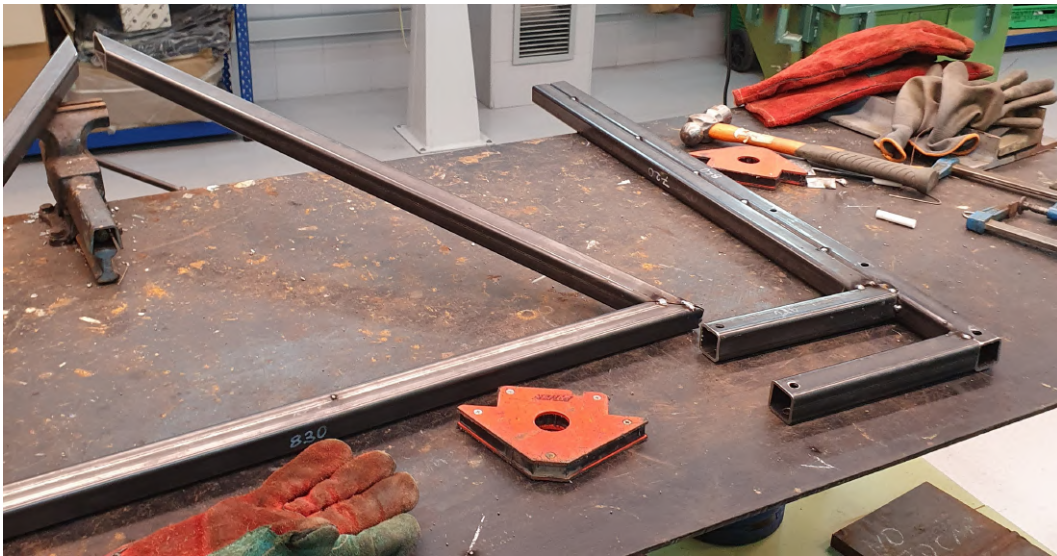
Figura 17: Puntos de soldadura en la base y brazo de la estructura. Fuente propia.
