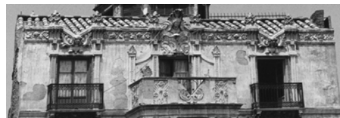
1053. Detalle de acabado y balcón de la fachada principal a Ancha del Carmen.
