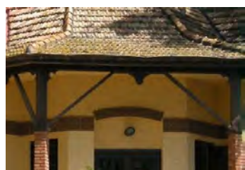
806. Escuadras y pilares de ladrillo en Octavio Picón 24.
