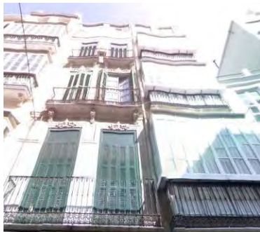
417. Fachada con el añadido, al que se le incorporaron miradores en los balcones.
