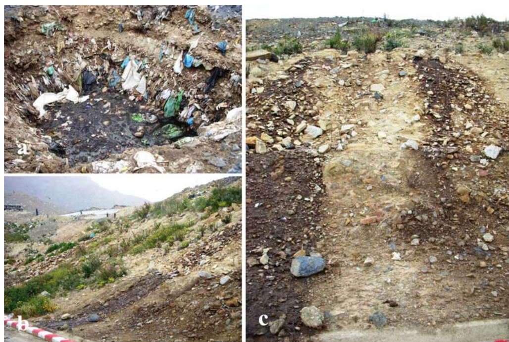
Figura 6.1. a – Cata que alcanza un nivel colgado de lixiviado en el vertedero 3, b y c – Infiltración del lixiviado a través de las capas de balas y de los sellados intermedios, en campo se aprecia un flujo muy lento y continuo. Sobre el terreno, se aprecia un flujo que atraviesa las balas y otro que se concentra en los sellados intermedios.
