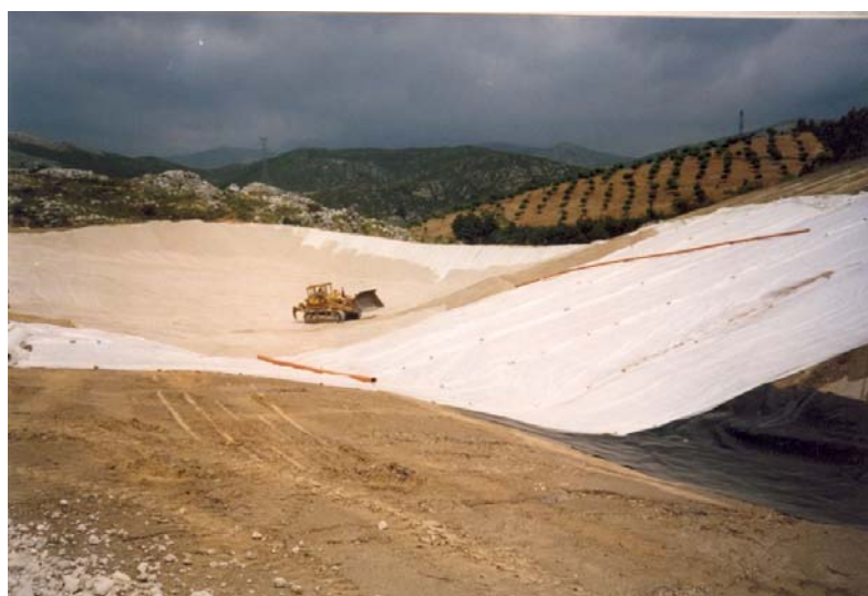
Figura 3.6. Utilización de un hueco dejado por una explotación de áridos como vertedero. Puede observarse la impermeabilización del vaso mediante capa de arcilla compacta (marrón), geomembrana de PEAD de 1,5 mm (negro) y geotextil (de color blanco).
