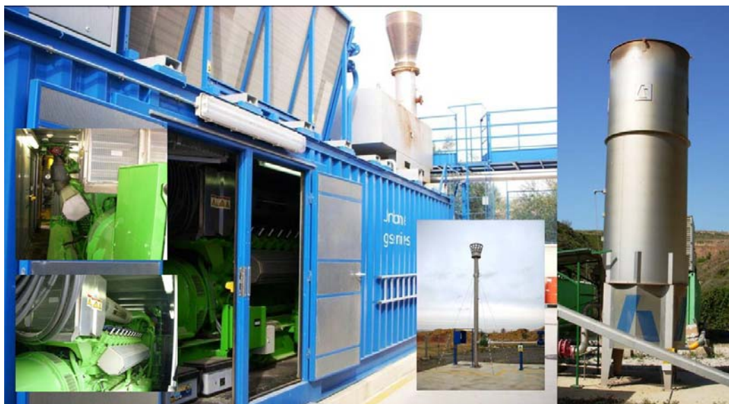
Figura 1.17. Grupo Generador de energía (combustión interna) de 1.4 MW y varios modelos de antorchas.
