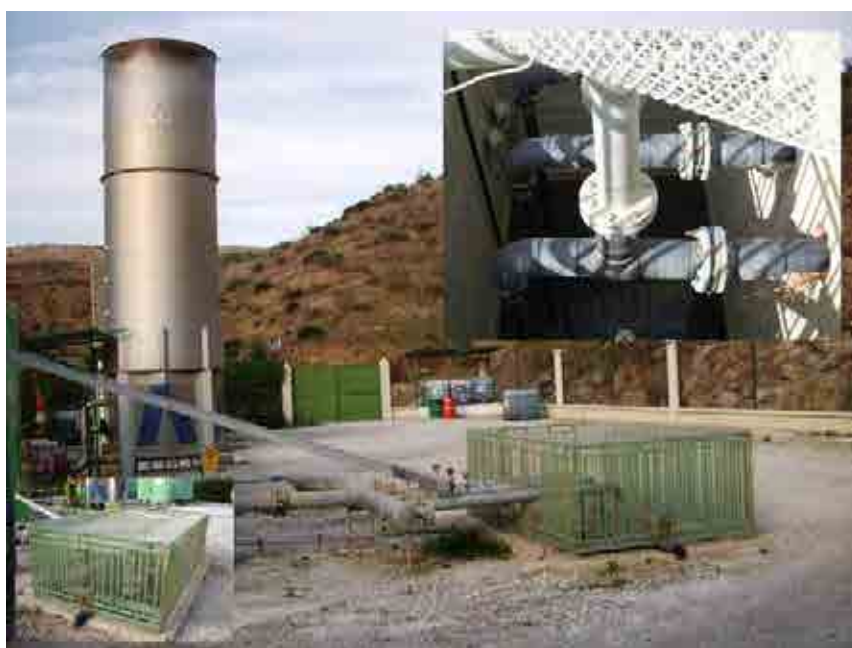
Figura 1.14. Antorcha y trampa para condensados previa a la conexión con grupo generados de energía.
