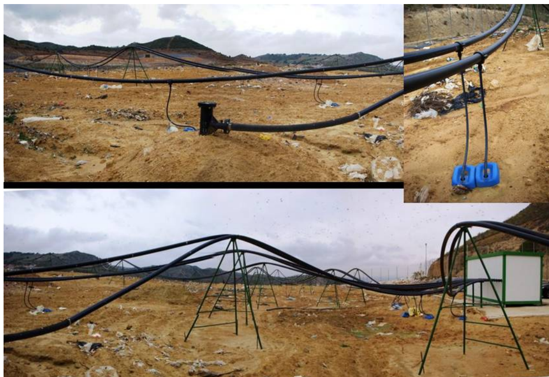
Figura 1.13. Conducciones elevadas sobre el terreno (HDPE) y purgas en cada comba de las tuberías, (detalle en esquina superior derecha), a fondo Estación de regulación.
