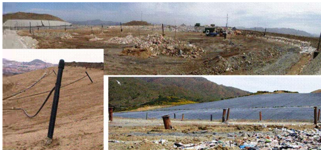
Figura 1.6. Pozos de extracción (primer término), chimeneas de desgasificación por venteo (abajo) y recrecimiento de chimeneas con el avance del vertedero activo actuando como pozos de venteo (arriba).
