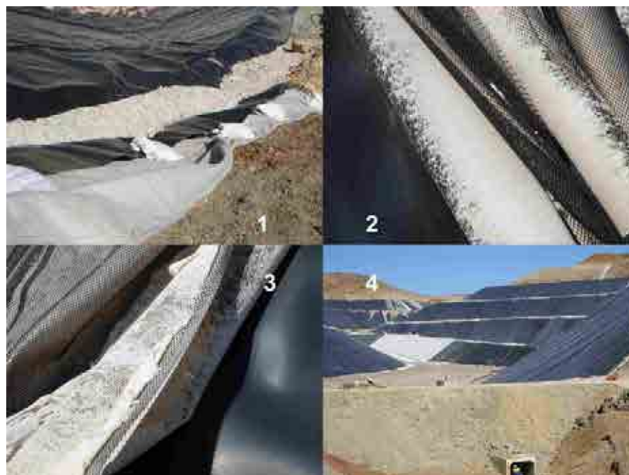
Figura 3.4. 1-Anclaje del geotextil y de la lámina de PEAD mediante zanja hormigonada, 2 y 3- Detalles de la geomalla sobre la lámina de polietileno, como consecuencia de las intensas lluvias del invierno de 2010 y de una prolongada exposición al sol puede apreciarse la degradación del geotextil y el desgarró del conjunto también visible en 4, al fondo.
