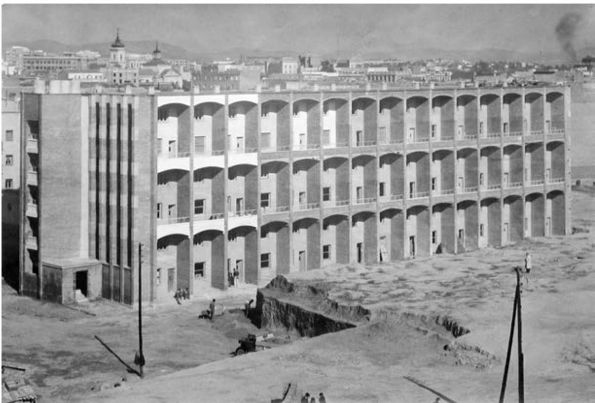
27-II. Fotografía de obra. Imagen de la obra en el momento que procede al enfoscado y pintado de los cantos de las bóvedas y los petos de las terrazas. A.A.C.
