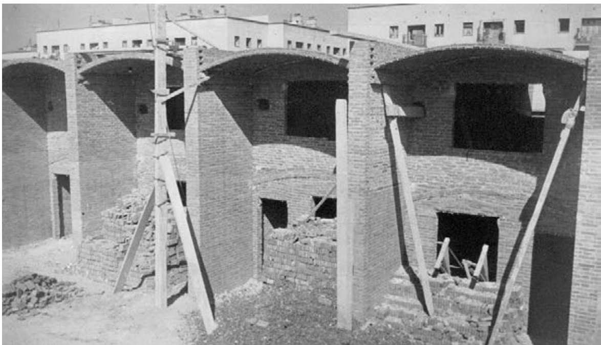
21-II. El aparejo. En esta fotografía de obra podemos apreciar el doblado en diferente dirección de las vueltas de rasilla, el apoyo en voladizo de las bóvedas y las elementales herramientas de elevación y apeo disponibles. A.A.C.
