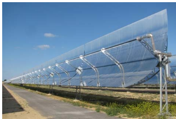
Figura 2.10: Valle 1, Planta de Canal Cilindro Parabólico de 50 MW. San José del Valle (Cádiz).
