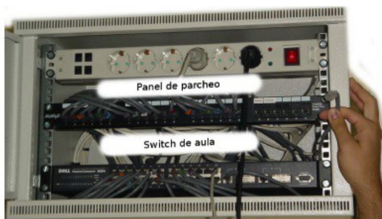
Ilustración 7: panel y switch de aula.
