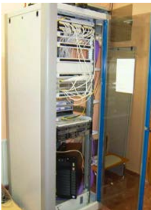
Ilustración 2: armario de datos, rack.
