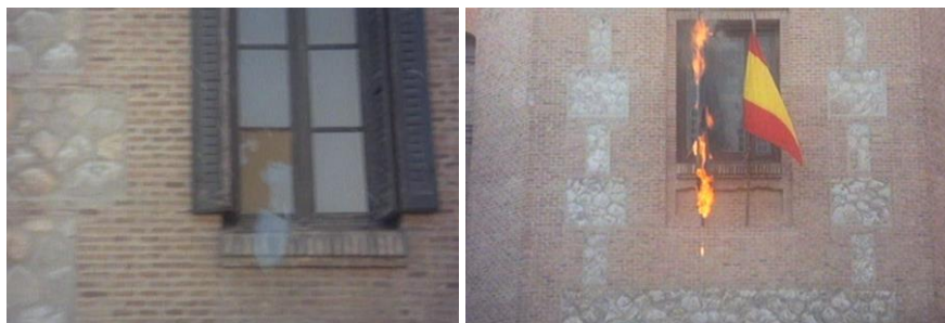
Fotogramas nº 5. a. y 5. b. Daños en el centro.
