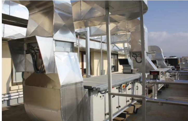
Figura 2. Climatizadores y enfriadora del sistema HVAC de la Unidad de Producción Celular del HRU de Málaga
