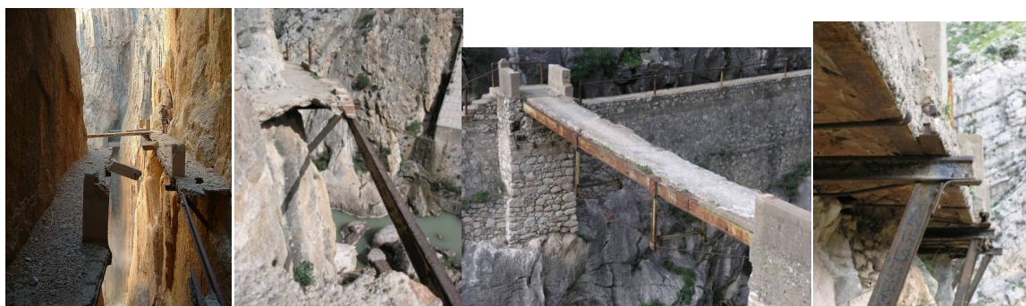
Fig. 4-5-6-7: Imágenes del mal estado de conservación del Caminito del Rey, previo a su recuperación. Fuente: Diputación de Málaga.
