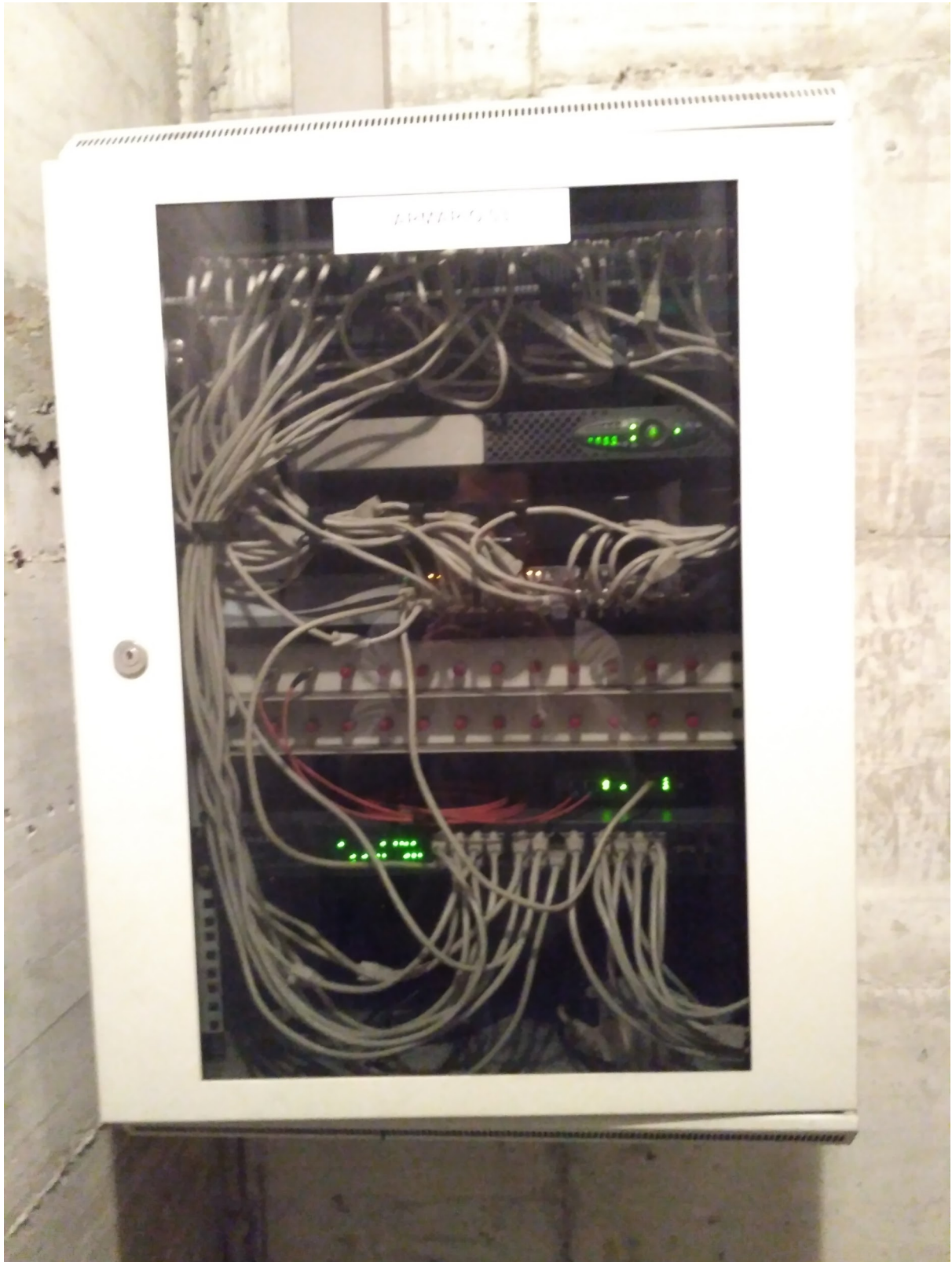
Figura 22: Armario rack antiguo
